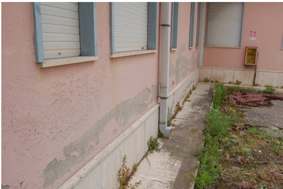
Foto n° 15 ammaloramenti intonaci strato di finitura
