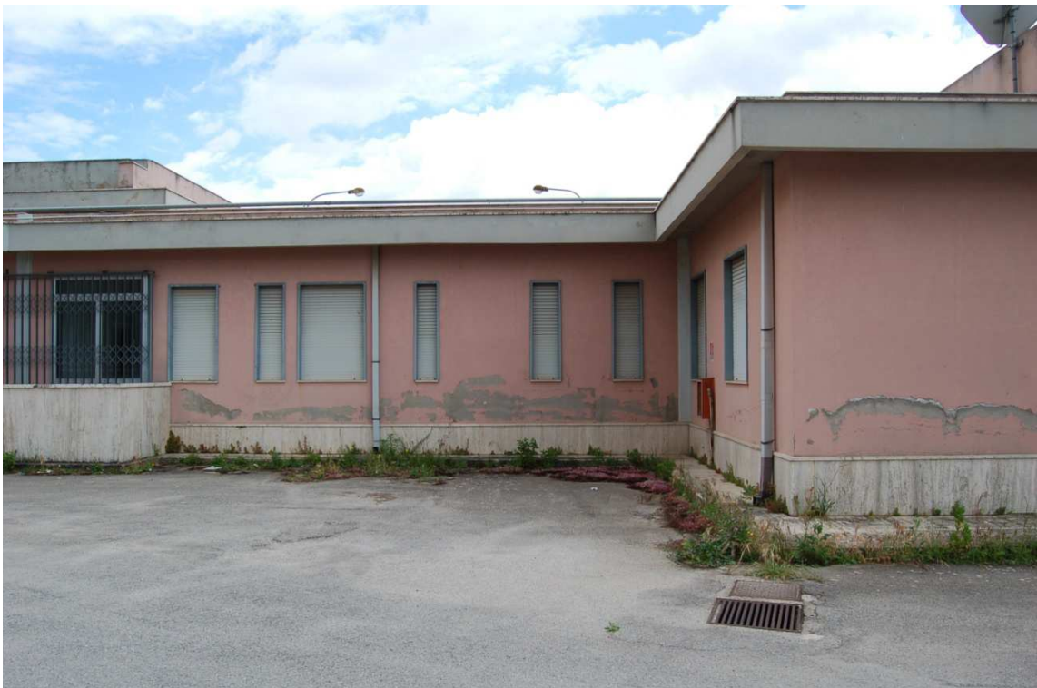
Foto n° 7 ammaloramento intonaci prospetto "2"
