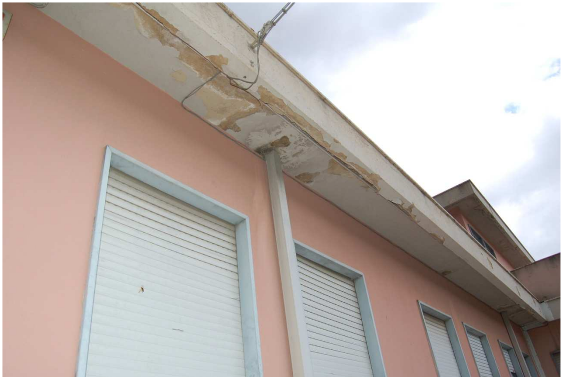
Foto n° 17 ammaloramento cornicione prospetto "1"
