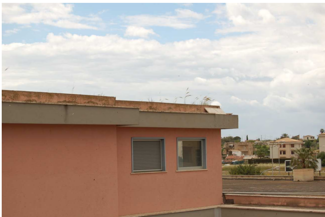
Foto n° 5 mancanza di copertine in marmo su muretti cornicione
