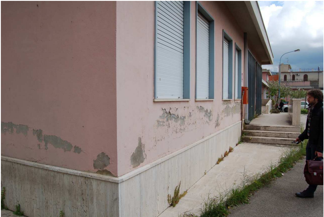
Foto n° 6 ammaloramento intonaco prospetto "1"
